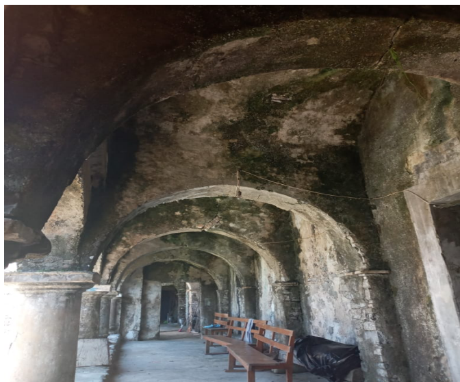
Imagen 25. Estructura antigua de la iglesia de Ixtepec, Puebla.
